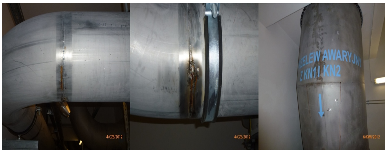
Fot. 4-16. Przykładowe obrazy przyspoinowych uszkodzeń korozyjnych stali 316L w stacji ozonowania
