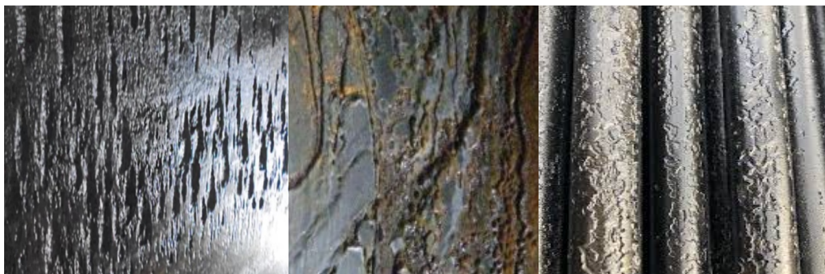
Fot. 4.7. Formy uszkodzeń instalacji mycia aminowego
