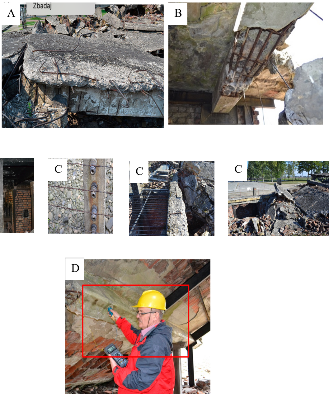
Fot. 4-5. A) Odsłonięte pręty zbrojeniowe ruin krematorium nr. 2 w Auschwitz II-Birkenau, B) Sufit komory gazowej tego krematorium, C) Typowe formy uszkodzeń konstrukcji betonowych, D) Tworzenie mapy potencjału elektrochemicznego na żelbetowej belce stropowej wewnątrz ruin krematorium nr 2 w Auschwitz II-Birkenau
