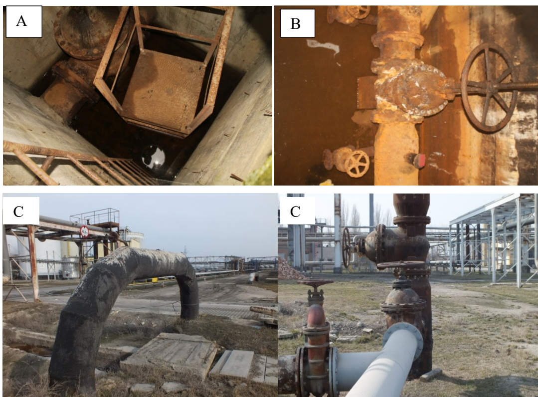
Fot. 4-13. A) Stan przykładowej studzienki, B) Stan korozyjny armatury (zasuwa), C) Widok powierzchniowych części rurociągów transportowych
