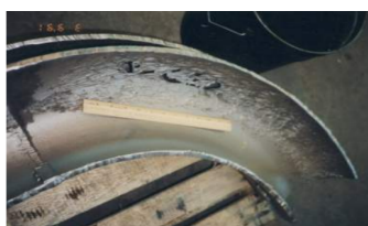
Uszkodzenie erozyjno-korozyjne kolanka ze stopu 5Cr. Wylot podgrzewacza
